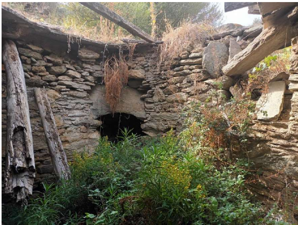
Κατεστραμμένη οροφή νερόμυλου
