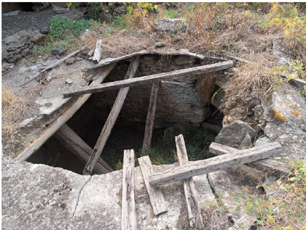
Κατεστραμμένη οροφή νερόμυλου
